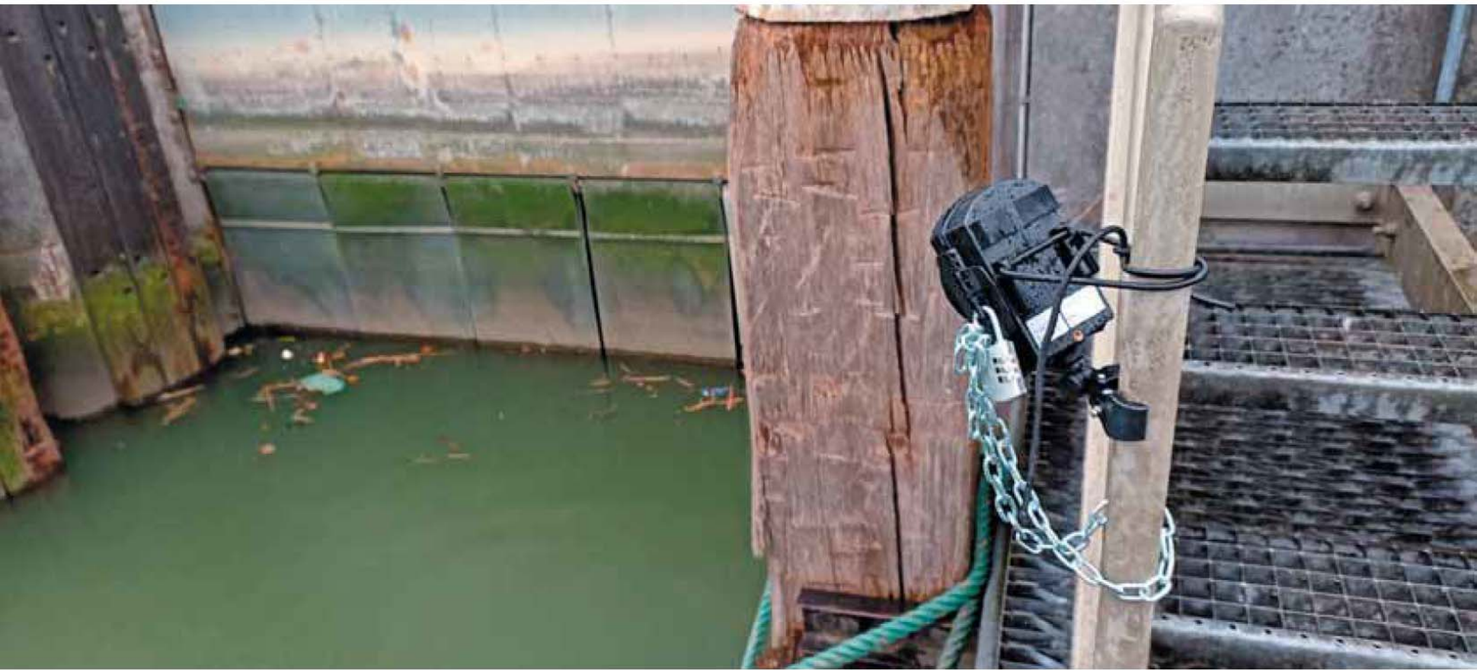
Foto: Situering van Camera 2 bij AVR in de Keilehaven, Rotterdam
